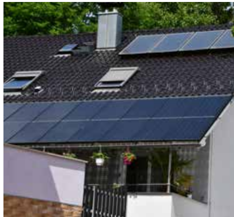
Abb. 5: Balkonüberdachung mit Solarmodulen.
