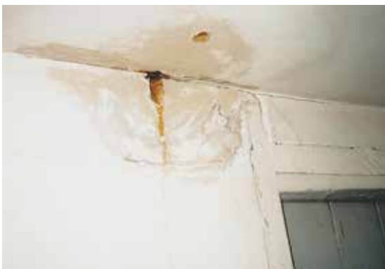
Feuchteschaden im Dachraum
