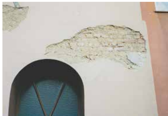
Putz blättert von der Fassade
