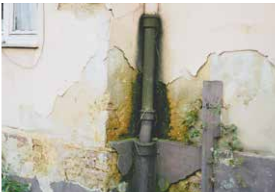
Defekter und feuchter Sockel
