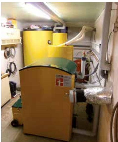
Abb. 4: Feuerungsanlage für Holzpellets. Der gelbe Zylinder in der Mitte enthält das Gebläse.
