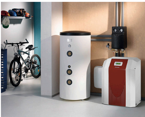
Abb. 8: Erdwärmepumpenanlage mit Wärmepumpe (rechts) und Pufferspeicher (links).
